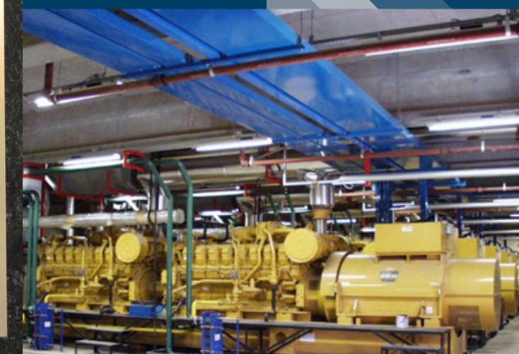
MOTORES A GÁS 5X1600 KW
